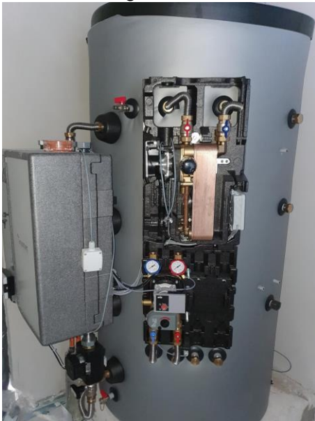
Abbildung 6: Wärmeübergabestation mit Speicher. Quelle: UBP-consulting GmbH & Co. KG.
