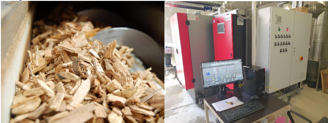
Abbildung 4: Hackschnitzelkessel. Quelle: UBP-consulting GmbH & Co. KG.
